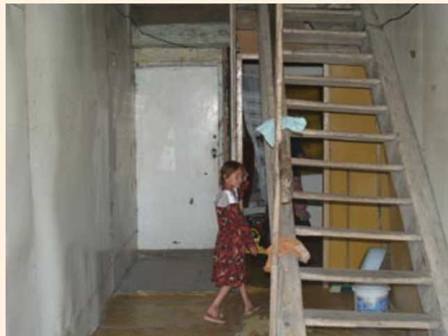
Odrapane, zawilgocone ściany. Tak wyglądają wnętrza budynku.
